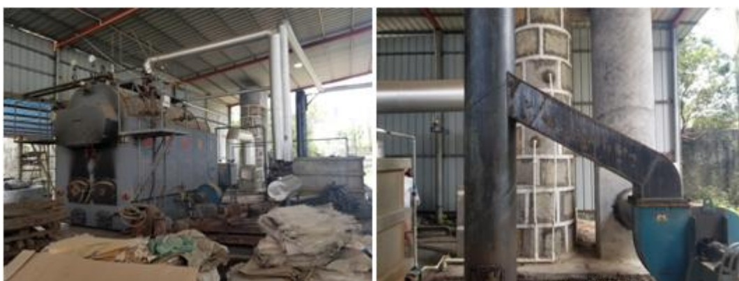
图 4.1-3 锅炉及其废气排气筒图
